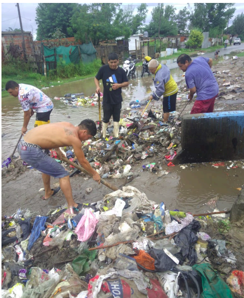
Vecinos en Empalme Graneros destapando un canal pluvial que descarga en el arroyo
